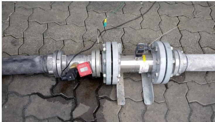
Abbildung 21: Messstrecke für Volumenstrom und Druck
